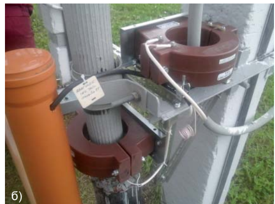
Рис. 4. Для измерения токов перехода «кабель-воздух» использованы накладные трансформаторы тока, подключенные поверх экрана кабеля и на заземляющем спуске
