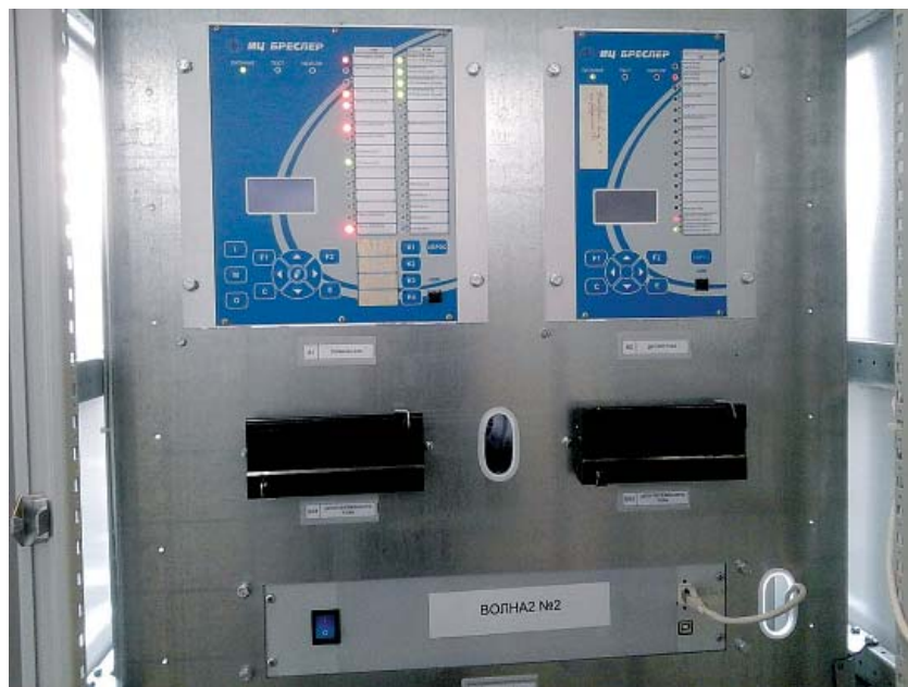
Рис. 1. Терминалы ДТ, АУВ2 и ВОЛНА2, установленные в шкафу ПС «Горенки»: слева сверху — терминал АУВ2, справа — терминал ДТ, ниже — терминал ВОЛНА2
